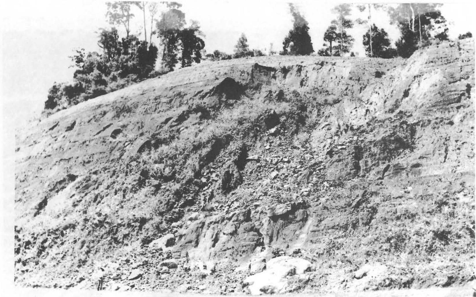
Fotograf 3: Kegagalan lingkaran (B1-b) pada cerun batuan akibat sifat jasad batuan yang hancur di lokasi 61.1U.
